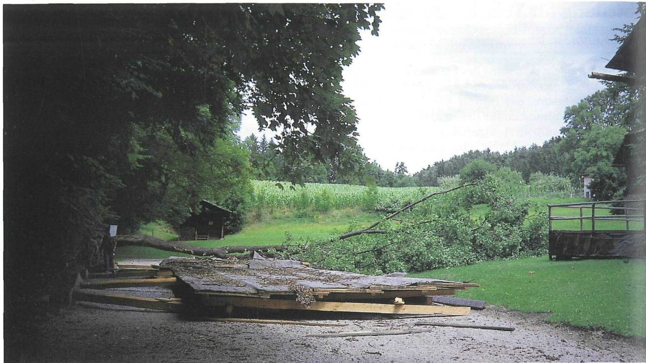
Abb. 2: Das erst vor einem Jahr errichtete Flugdach wurde durch die Wucht des umfallenden Baumes aus seinen Verankerungen gehoben und zu Boden gedrückt. Aufn. J. Schwertner
