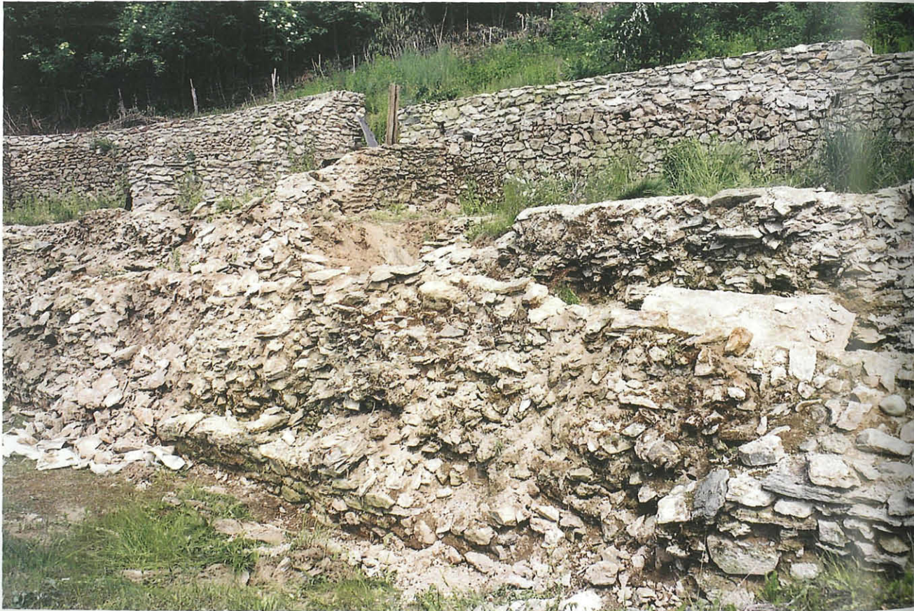
Abb. 3: Ost-Cavea. Versturz im Bereich des Zugangs 4. Die verstürzten inneren Caveamauern M 1 und M 2; im Hintergrund die teilsanierten Bereiche der äußeren Mauer M 3. Deutlich erkennbar ist das taube Mauerwerk unterhalb der sanierten Krone der M 3 und die durch den Hangdruck schräg zur Arena geneigte M 1. Aufn. R. Barlovits
