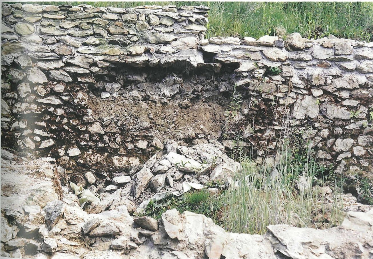
Abb. 4: Ost-Cavea, mittlerer Teil. Mauerausbruch in der äußeren Caveamauer M 3 unterhalb der 2001 sanierten Mauerkrone. Blick aus Westen. Aufn. R. Barlovits
