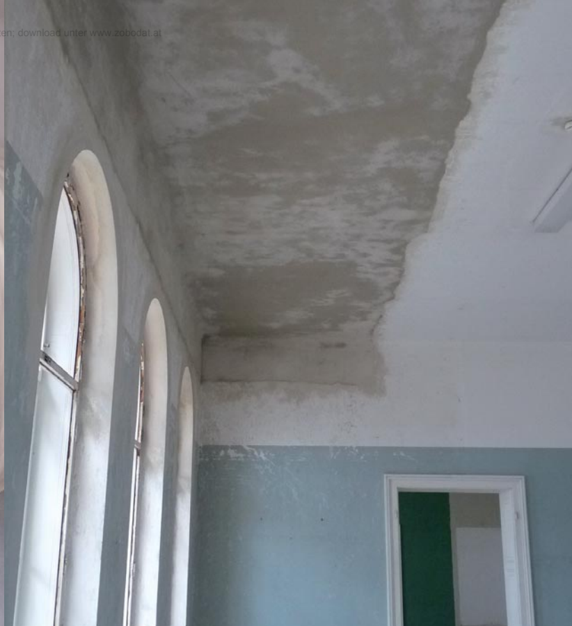
Abb. 23: Aufgrund des Hausschwamms, der im Dachgeschoß des Rudolfinums aufgefunden wurde, mussten an einigen Stellen großflächige Deckensanierungsmaßnahmen im Innenraum durchgeführt werden. Aufn. T. Jerger
