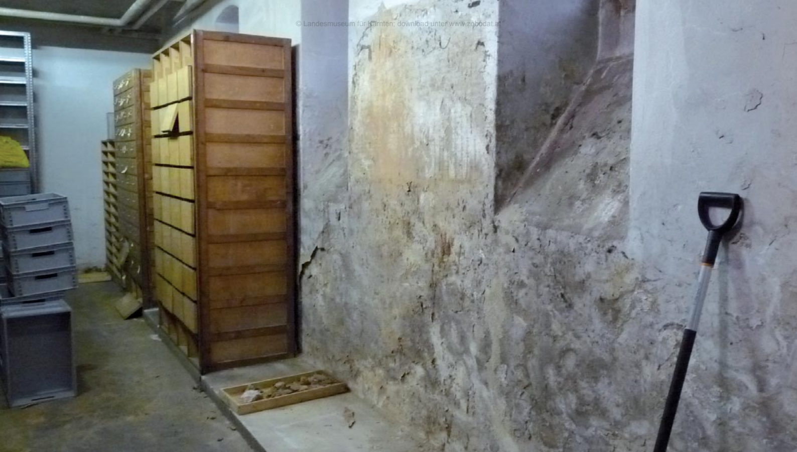
Abb. 19: Blick in das ehemalige Depot der Geologie/Mineralogie im Keller des Rudolfinums mit großflächigen Feuchtigkeitschäden. Die falschen klimatischen Bedingungen führten dazu, dass Bestände aus den Sammlungen der Mineralogie regelrecht zu Staub zerfallen sind. Aufn. K. Allesch
