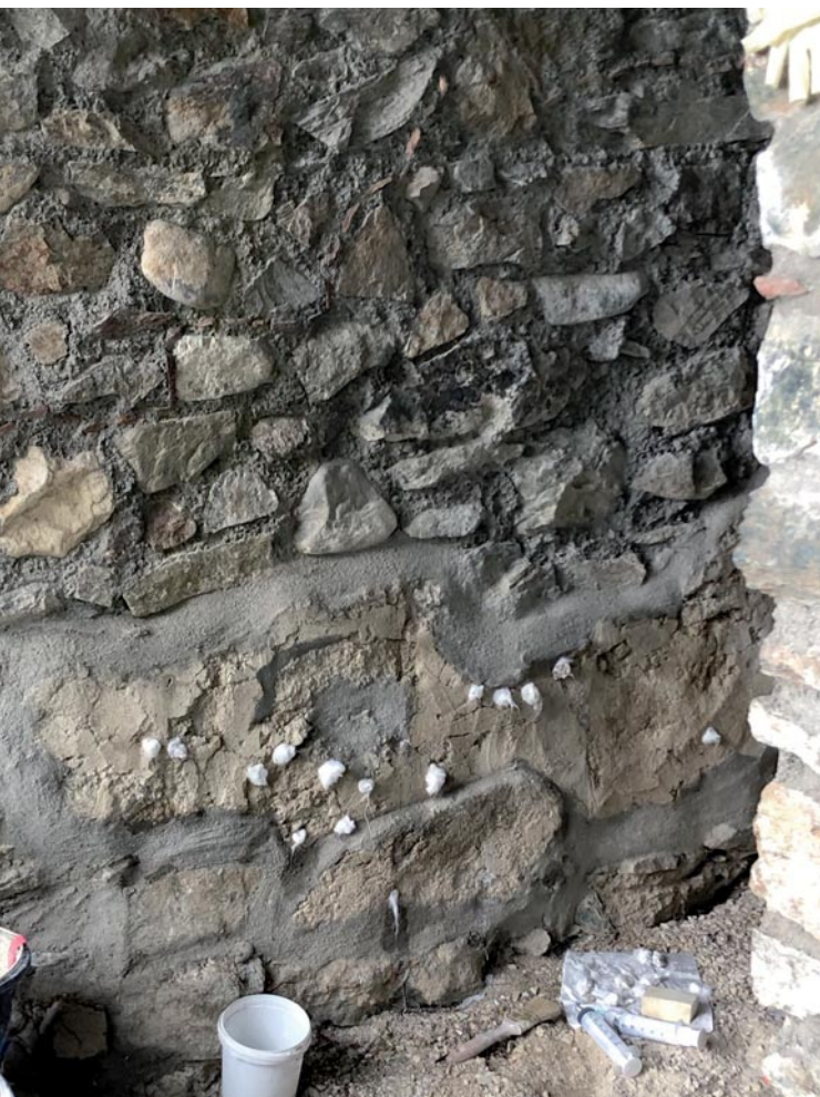
Abb. 2: Gebäude AA/36: Mit Watte verschlossene Injektionslöcher in Putz mit starken Fröhschwundrissen. Aufn. L. Huck
