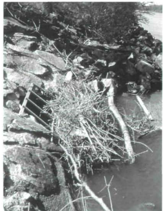
Abb. 82: Oberstromiger Rohrdurchlaß mit Verklausung.
