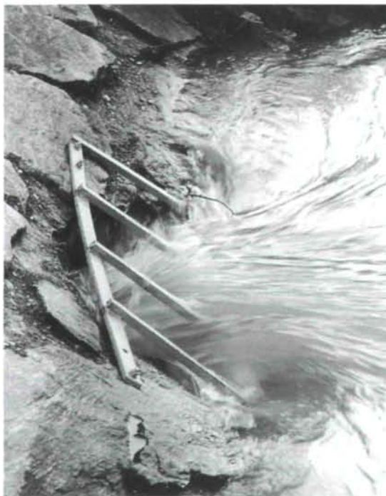
Abb. 81: Oberstromiger Rohrdurchlaß ohne Verklausung.
