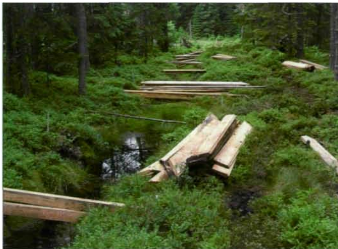
Abb. 8: Insgesamt wurden mehr als 40 Tonnen Baumaterial zu den festgelegten Sperrenstandorten ins Moor getragen (Foto: M. PÖSTINGER)
