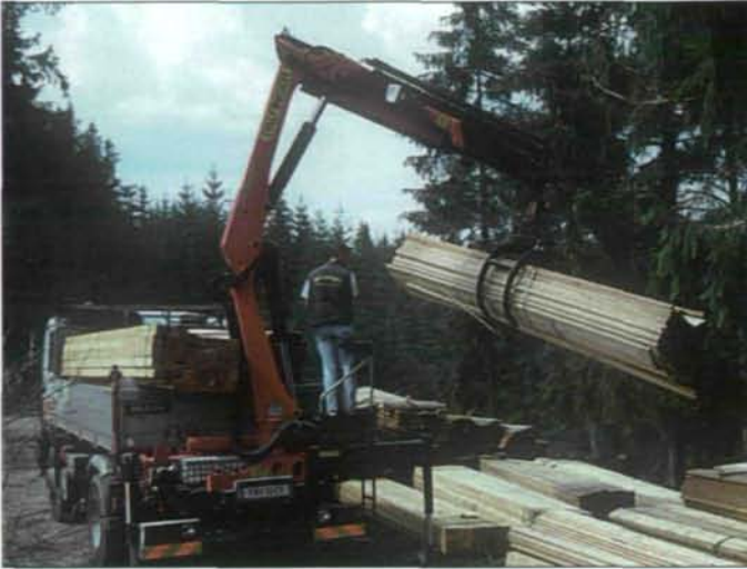
Abb. 6: Der Transport des Lärchenholzes vom Zwischenlager in Weiersfelden zum Lagerplatz vor Ort erfolgte durch einen LKW mit Kranvorrichtung, (Foto: M. PÖSTINGER)
