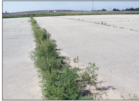
Abbildung 58: Intensiv bewachsene Querfuge der Asphaltbefestigung (Foto: G. SCHINDLER). – Ambrosia artemisiifolia in a gap in the asphalted surface (Photo: G. SCHINDLER).
