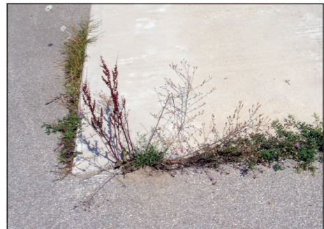
Abbildung 6: Ambrosia artemisiifolia in einer Spalte am Ende der Auffahrt auf eine Brückenswaage (Foto: G. SCHINDLER). – Ambrosia artemisiifolia growing in a gap at the end of the ramp to a weighbridge (Photo: G. SCHINDLER).
