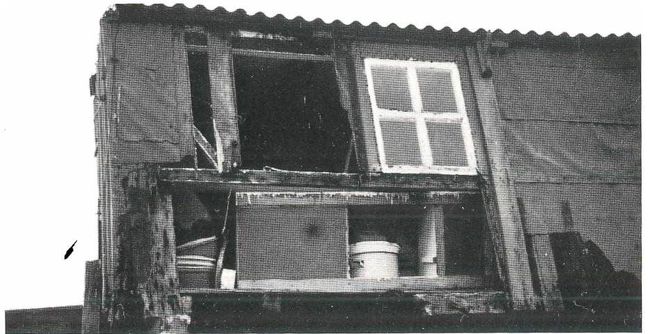
Sturmschäden an der »Jens Wand Hütte«/Norderoog.
