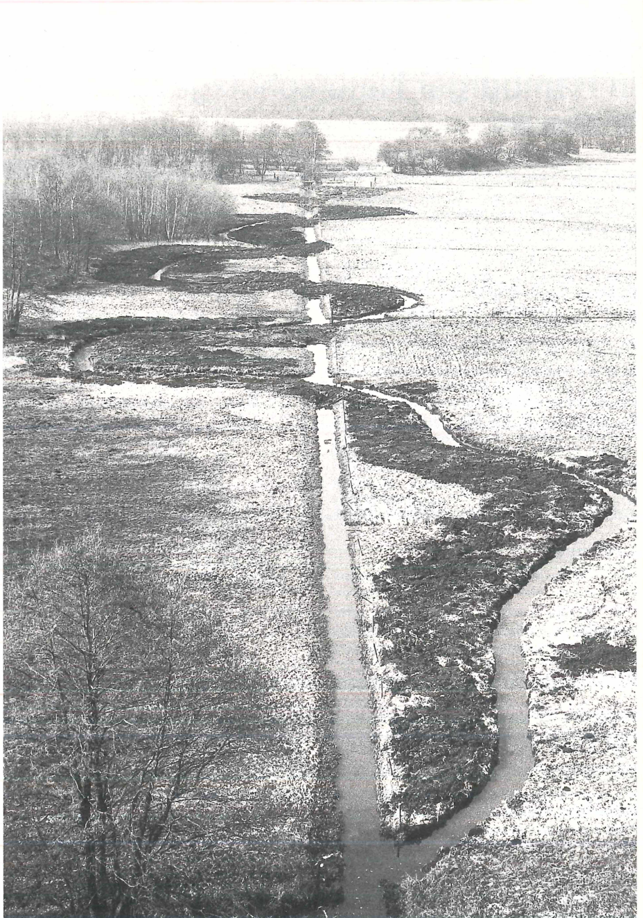
Abb. 2: Der 1982 fertiggestellte 1. Bauabschnitt des wiederhergestellten, ehemaligen Wandselaufes, eines trägen Wiesenbaches, kurz nach der Baumaßnahme.
