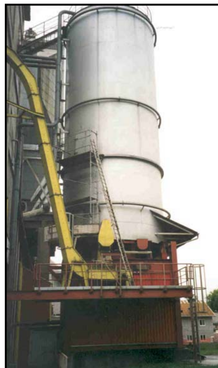
Abbildung 21: Übernahmestelle und Silo für Ersatzbrennstoffe
