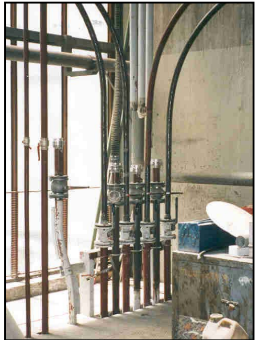
Abbildung 26: Tiermehlförderleitungen – von den Silos zu den Brennern
