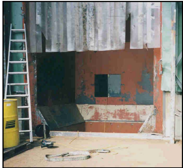
Abbildung 8: BRAM-Annahnebunker des WSO 3
