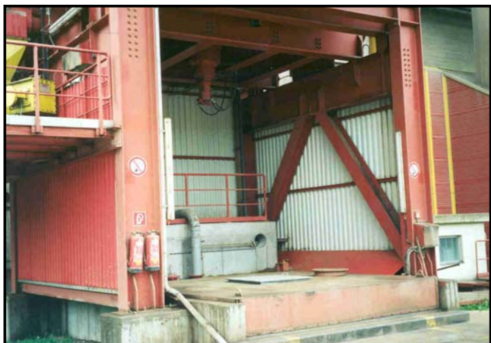
Abbildung 19: Übernahmestelle für Ersatzbrennstoffe
