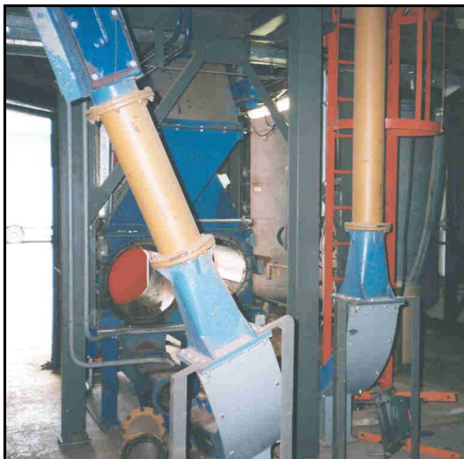
Abbildung 11: Förderleitungen nach der Wägevorrichtung
