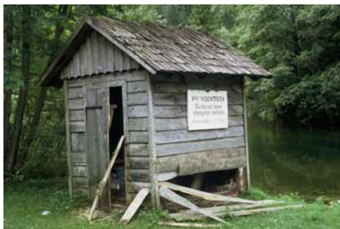
Bärenschaden an einer Hütte in der Fischfutter gelagert wurde.
