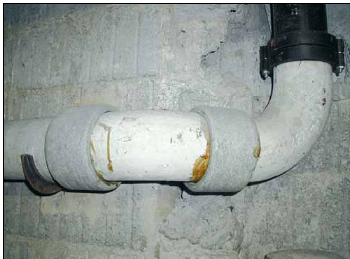
Foto 7: Abflussrohr aus Asbest (SUVAPRO 2007).
