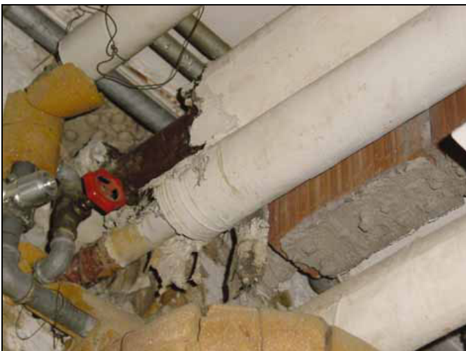
Foto 9: Asbestisolierung um Heizleitungen (SUVAPRO 2007).
