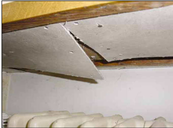
Foto 6: Asbestleichtpressplatten zur thermischen Isolation einer Fensterbank (SUVAPRO 2007).
