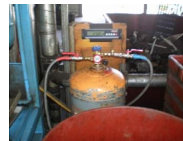
Stufe I, Sammelbehälter Kompressoröl
