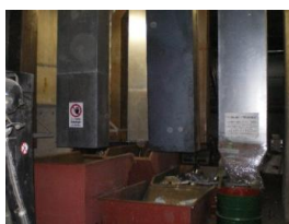
Abwurfschächte mit Auffangbehältern
