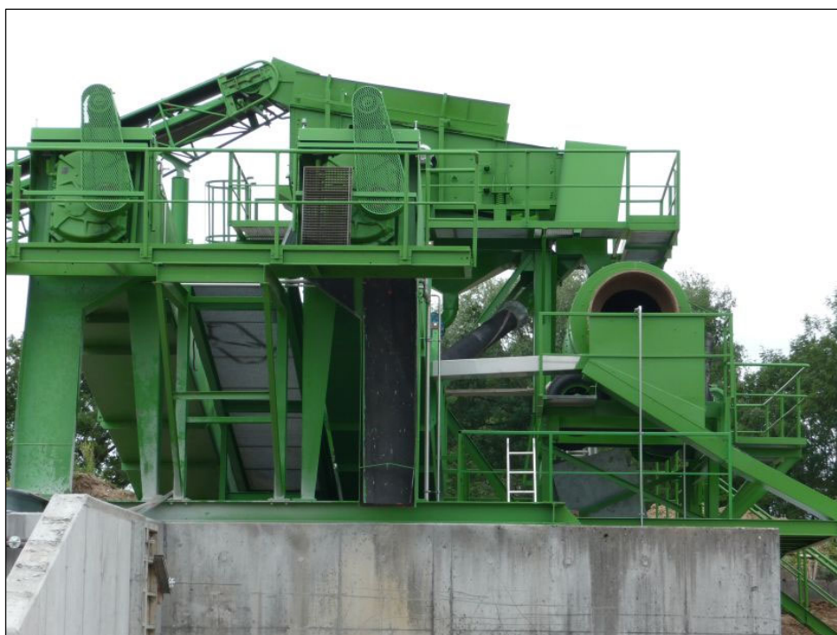
Abbildung 22: HAELA Abfallverwertung GmbH – Waschanlage, rechts sichtbar sind die Waschtrommel, links die Antriebe der Wasch- schnecken, darüber die Siebeinrichtung (© Umweltbundesamt).
