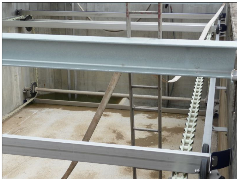
Abbildung 23: HAELA Abfallverwertung GmbH – Schlamm- absetzbecken, links und rechts sind die Antriebe der Schlammräumer zu sehen (© Umweltbundesamt).
