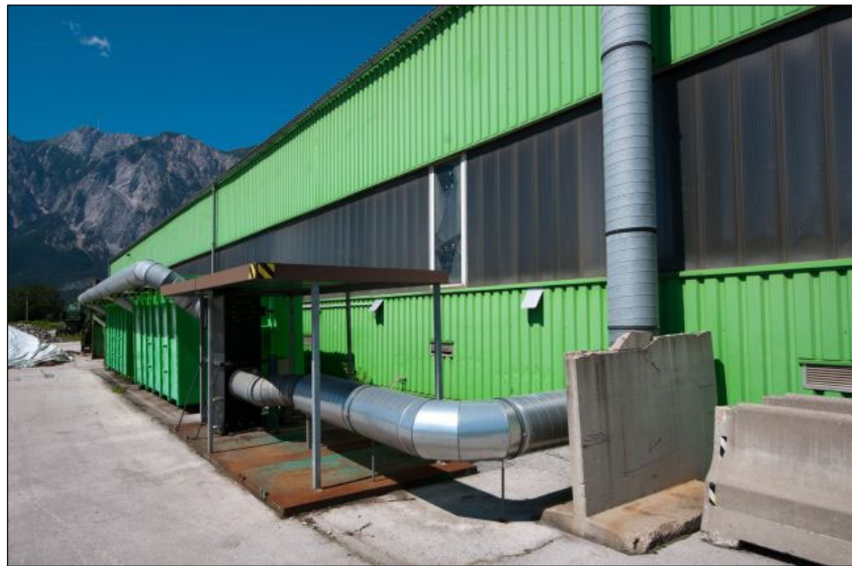
Abbildung 8: Ökotechna – Abluft- reinigungsanlage (links im Hintergrund die Biofilter) (© Umweltbundesamt).
