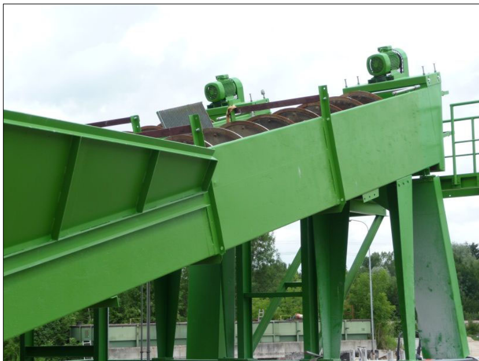
Abbildung 21: HAELA Abfallverwertung GmbH – Ansicht Waschschnellen mit Abwurftrutschen (© Umweltbundesamt).
