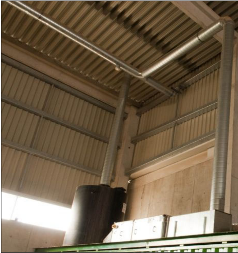
Abbildung 16: HAELA Abfallverwertung GmbH – Teil des Abluftfassungssystems und Aktivkohlefilter (schwarzer Behälter) (© Umweltbundesamt).
