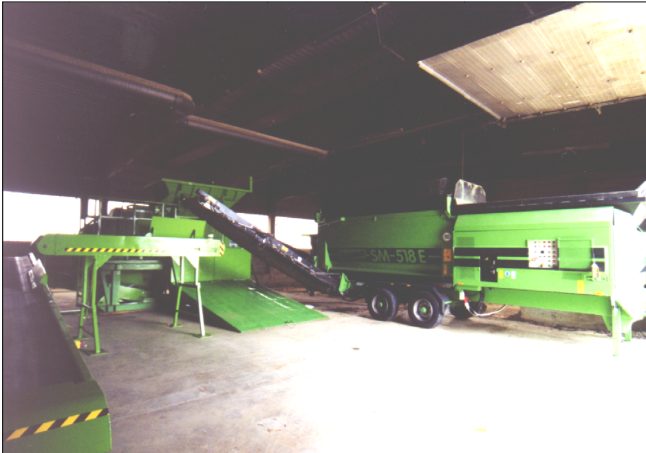
Abbildung 5: Ökotechna – Brecher und Siebanlage (© ALTEC).
