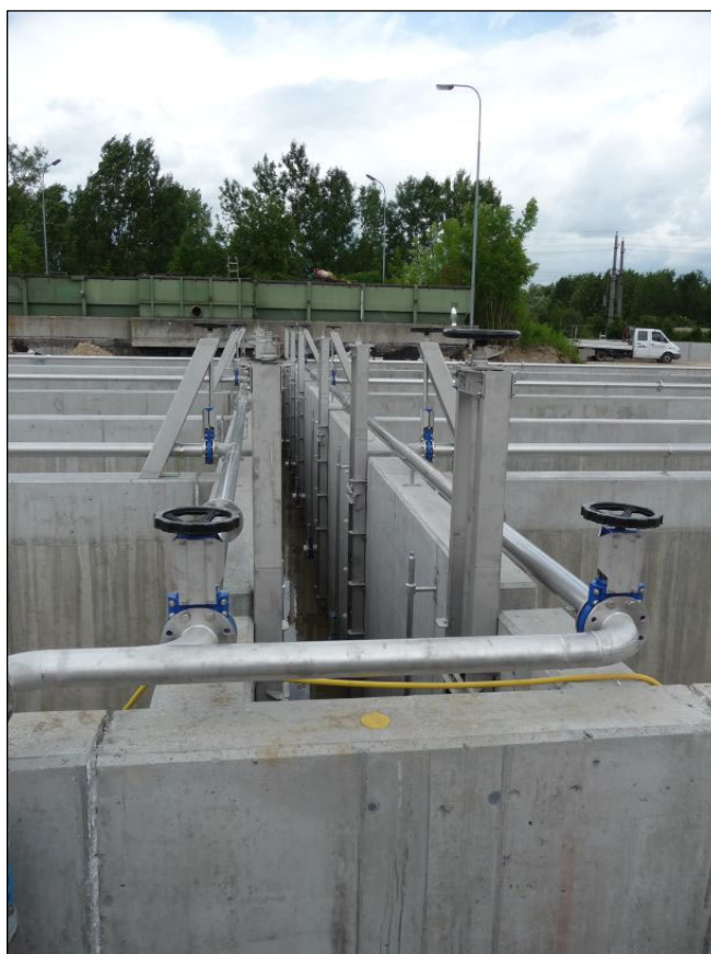
Abbildung 24: HAELA Abfallverwertung GmbH – Schlamm- trockenbecken mit Schieber für die separate Beschickung (© Umweltbundesamt).
