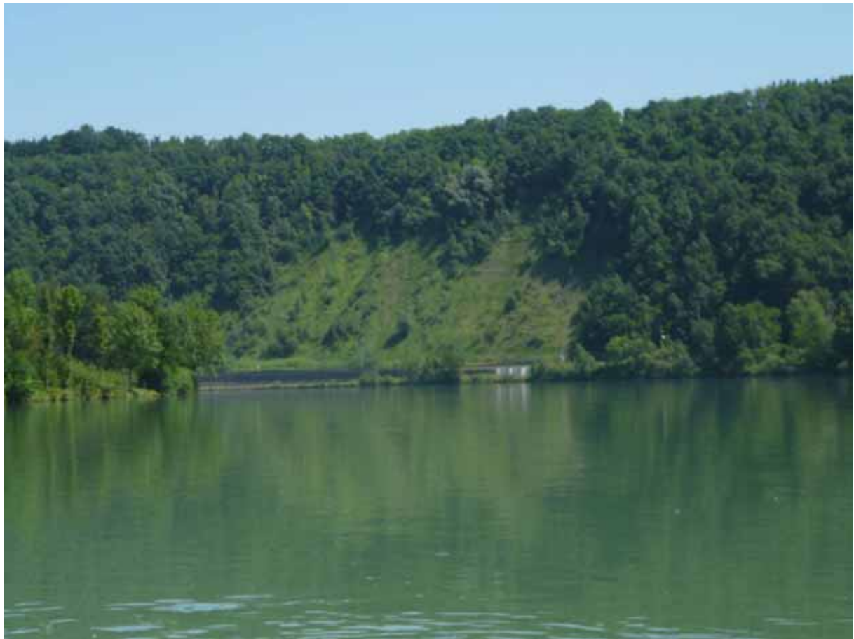
Foto A 61: Wie Foto A 60, Sommer. Die Schlierabbrüche wachsen zu, da sie mit Drahtgeflechten stabilisiert wurden.
