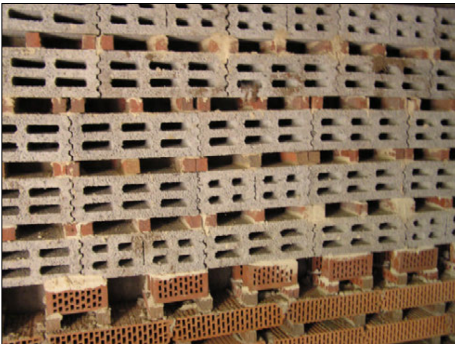
Abb. 2: Versteckplätze durch aufgemauerte Hohlblocksteine in einem Winterquartier für Fledermäuse in Wilsede.
