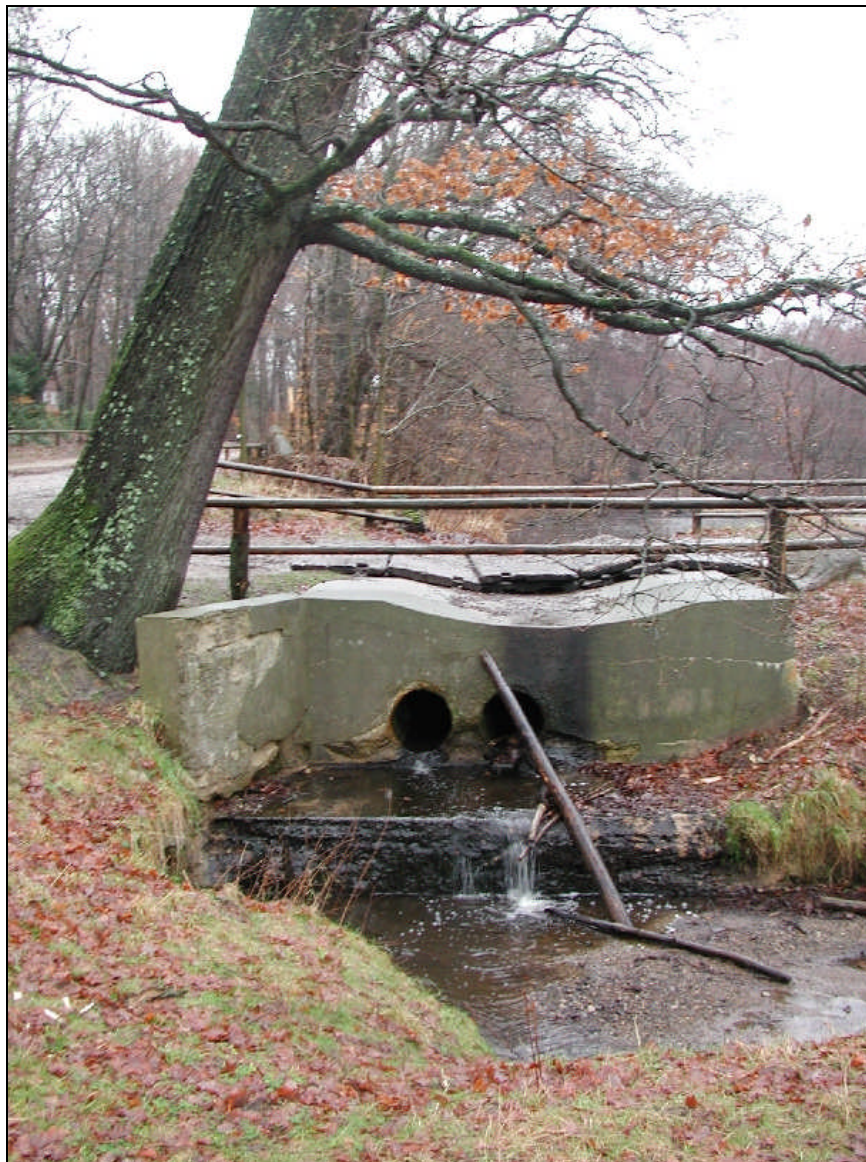
Abb. 19: Zustand der Haverbeeke unterhalb des Niederhaverbecker Feuerlöschteiches vor der Renaturierungsmaßnahme (Foto VNP-Archiv).
