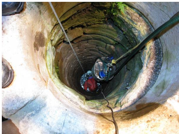
„Kaskaden-Pumpen“ im Brunnenschacht
