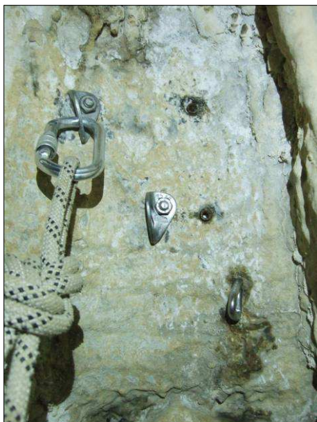
Abb.1: 5 Verankerungen wo nur eine nötig wäre. Foto: B. Wielander
