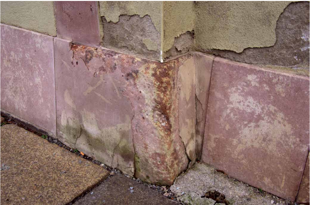
Abb. 7 Mörtelergänzungen und Neuteile in einer verwitterten Sockelzone aus Hilbersdorfer Tuff.
