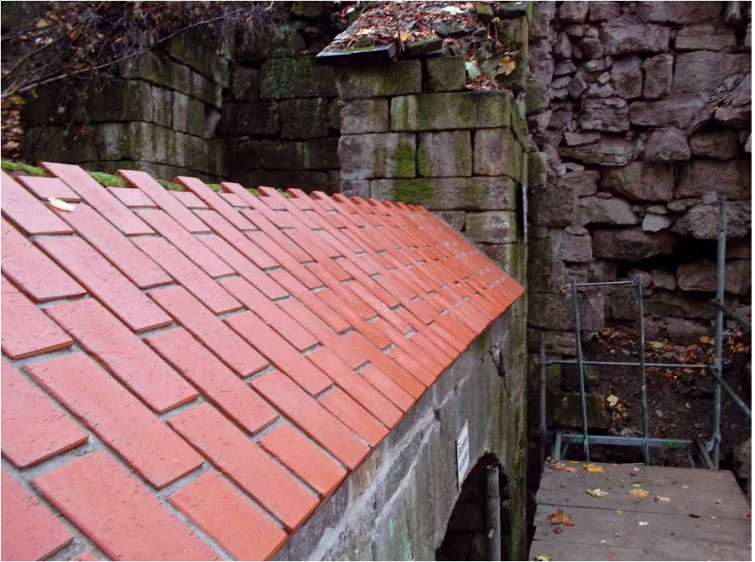
Abb. 4 Stützpfiler Nummer 1 im Zustand Oktober 2013
