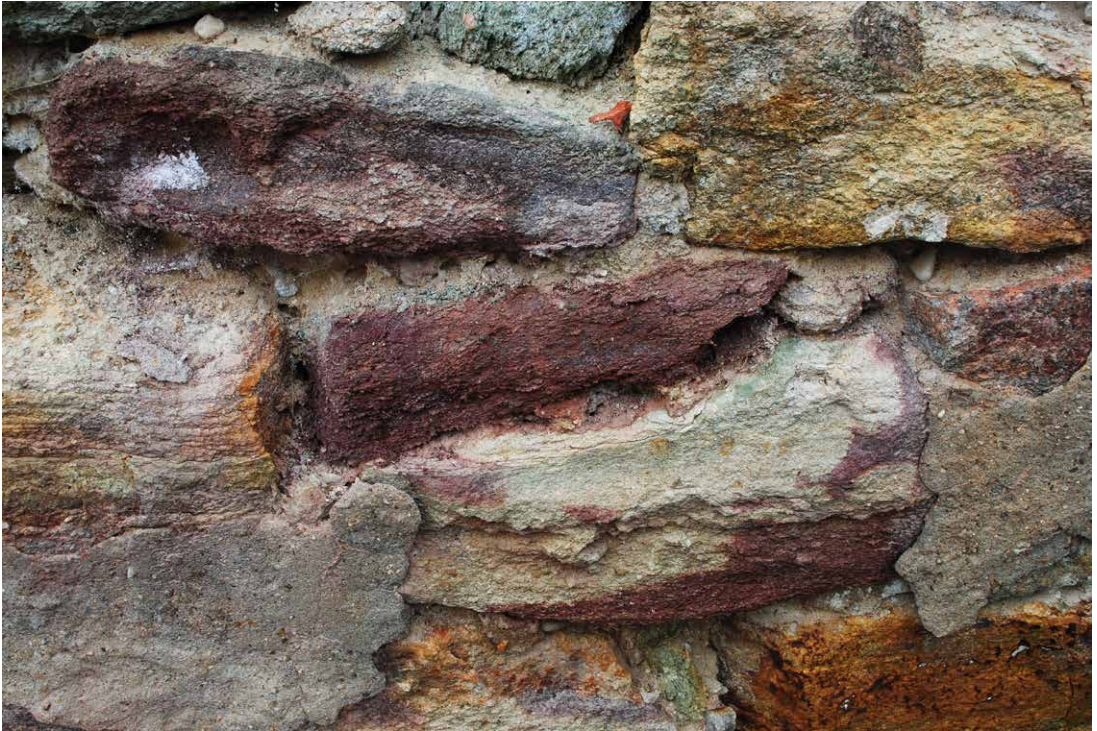
Abb. 20 Mauerwerk eines älteren Gebäudes in Buchheim mit verschiedenen Varietäten der lokalen Pyroklastite.
