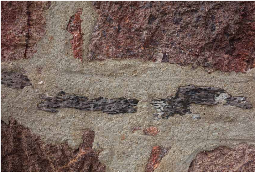
Abb. 13 | Mauerwerk aus Porphyrtuff mit Abstandhalter aus Fruchtschiefer in der Mörtelfuge an einem Haus in Rochlitz. Die Aluminiumsilikate im Fruchtschiefer sind ausgewittert und bilden Hohlformen.
