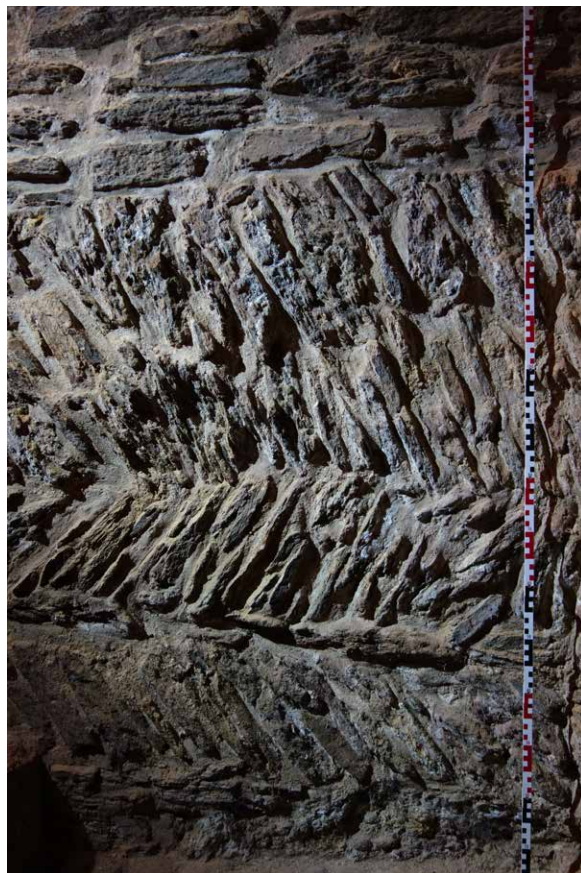
Abb. 11 | In der Art des opus spicatum versetztes Mauerwerk unbekanntes Alters aus Fruchtschiefer, Kellerabgang in Schloss Rochlitz.
