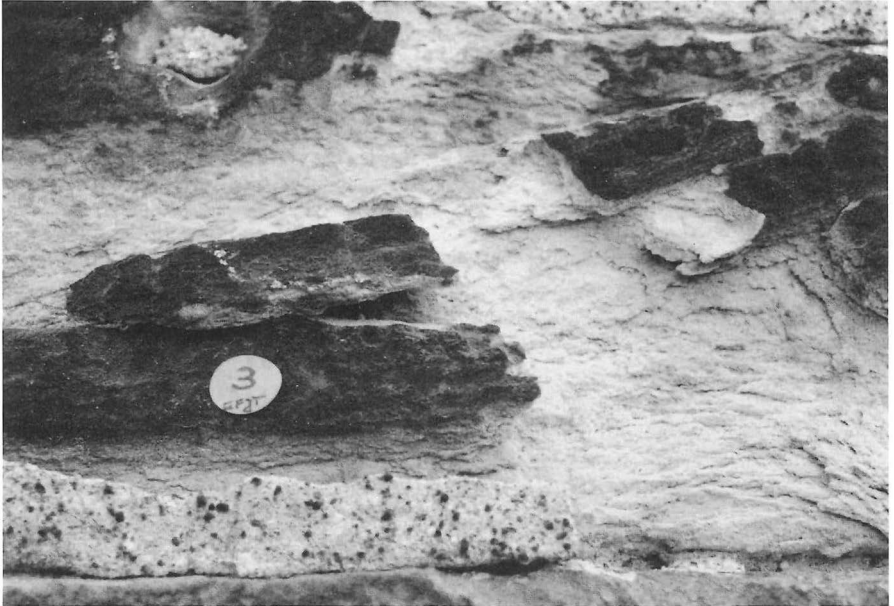
Abb. 6: Johannesturm, Turmhelm Nordostseite, schwarzer Belag (Probe JT 3)
