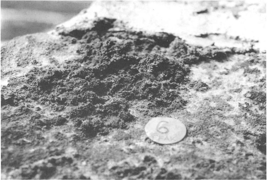
Abb. 8: Andreaskirchturm, Galerieausstieg Nordostseite, blumenkohllartige Kruste (Probe AK 6)
