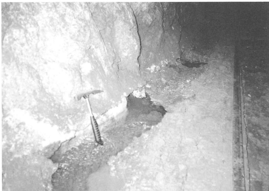
Abb. 3: Mommel, Richtstrecke NW im Niveau Tiefer Stollen, Unterhölung des Stoßes durch Anhydrit-Auslaugung
