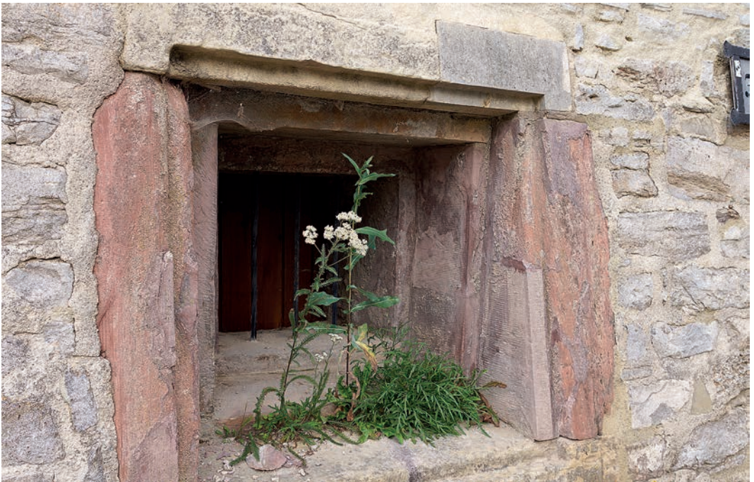
Abb. 9: Fensternische aus Sandstein mit Schafgarbe, Kompass-Lattich und Schmalblättrigem Doppelsame (neben Eingang zur Festungsschmiede, 04.08.2020).
