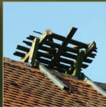
Sanierungsbedürftige Horstplattform in Rattelsdorf/Ofr.
