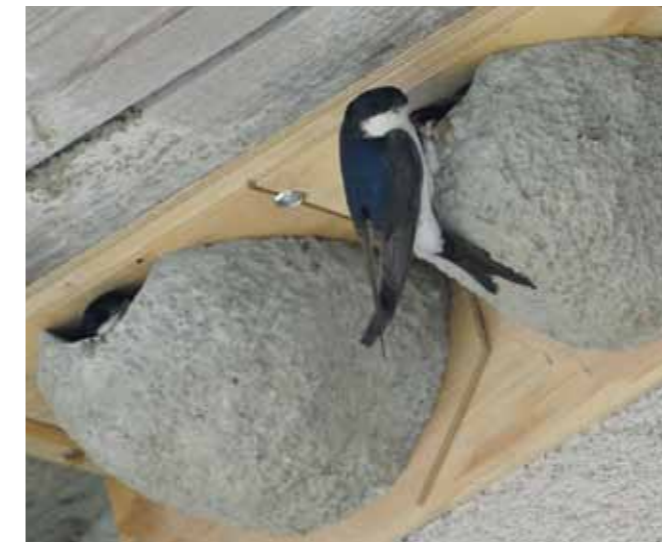
Nach Sanierungen angebrachte Kunstnester werden gerne angenommen; ein Kotbrett vermeidet unerwünschte Verschmutzungen unter dem Nest
