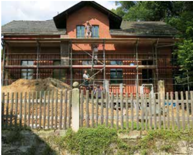
Nach Dokumentation der Bauschäden und umfangreichen Planungsarbeiten beginnen die Baumaßnahmen zur Generalsanierung der Brehm-Gedenkstätte in Renthendorf am 21. 8. 2014,
