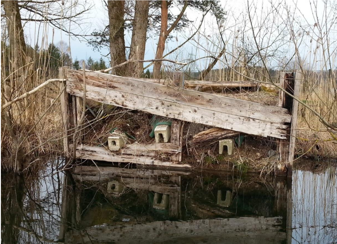
Abbildung 6: Verfallene Eisvogelbrutwand am Würm-Westufer in der Nähe des Klärwerks
