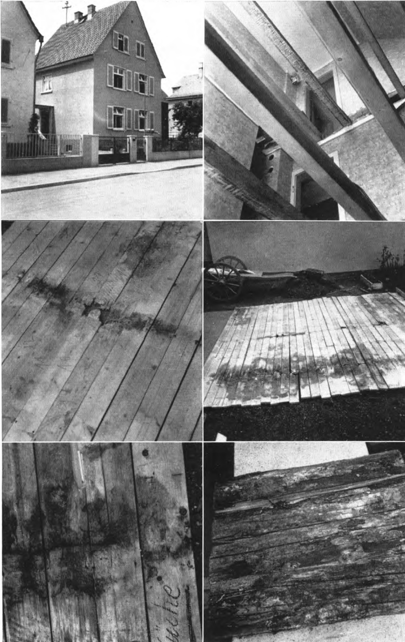
Schwammschäden in einem Neubau. Foto-Archiv F. Kallenbach, Darmstadt.
