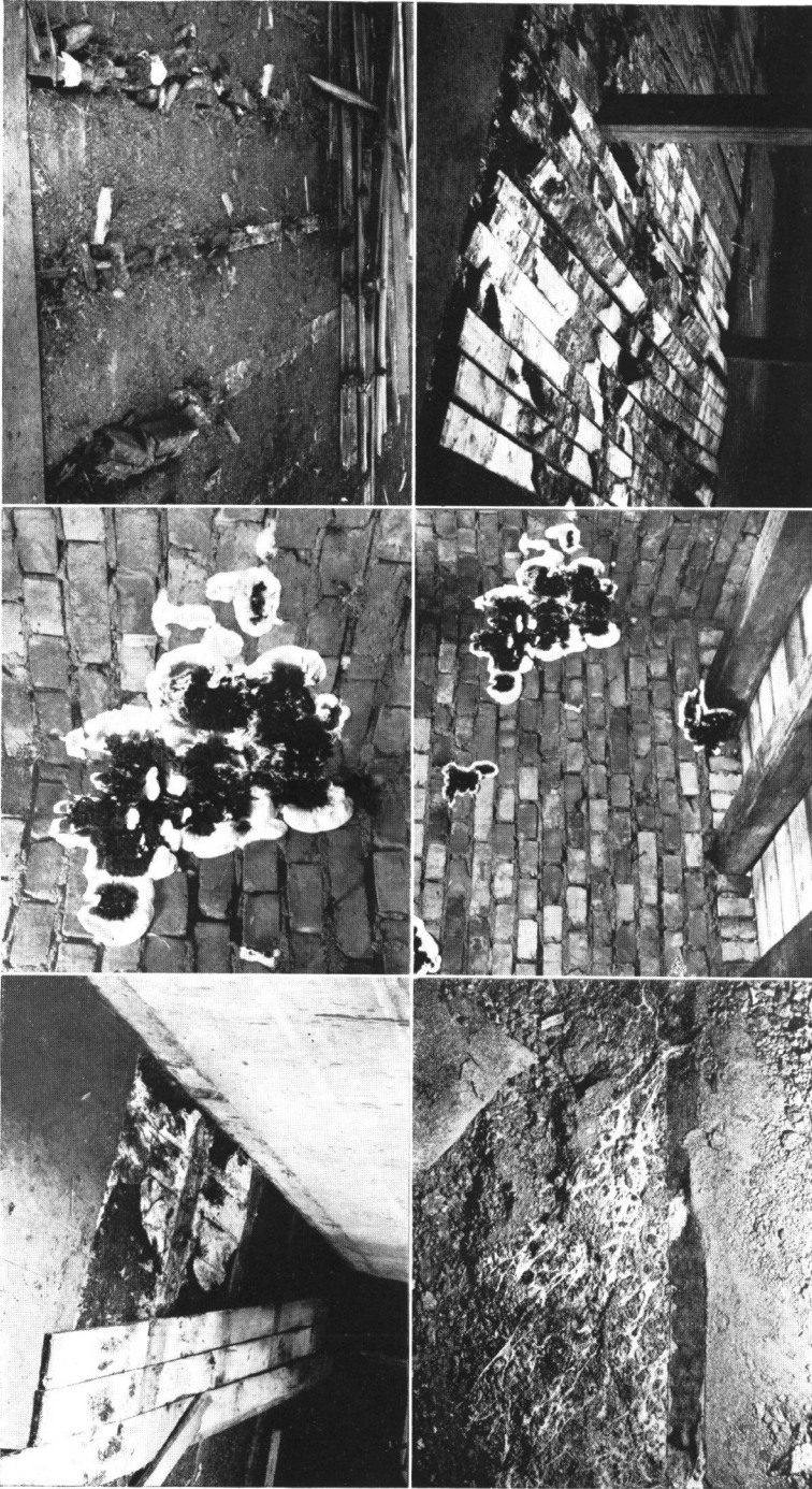
Bemerkenswerte Hausschwamm- und Pilzschäden. Ungenügende Sorgfalt in einem Neubau. Von F. Kallenbach, Darmstadt.
