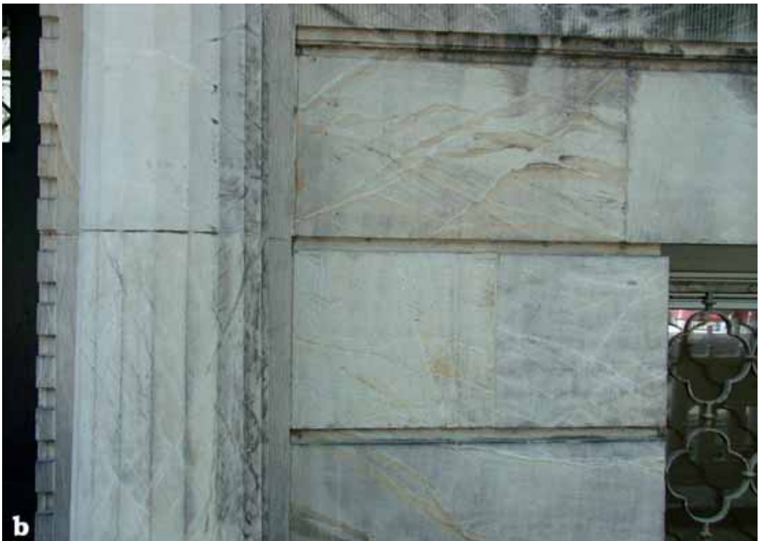
Abb. 7: Osning-Sandstein mit Scherfugen (Typ Grotenburg), a: Sockel des Hermannsdenkmals bei Detmold, b: Detail des Landtagsgebäudes in Detmold
