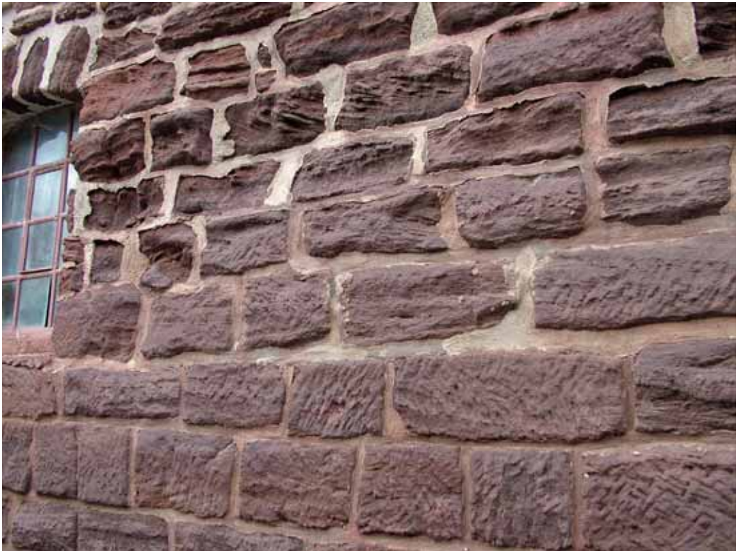
Abb. 9: Gault-Sandstein mit unterschiedlichen Verwitterungsbildern und starken Schäden im Abluftbereich der Fenster (Stallgebäude am Stadtweg in Herbram, erbaut um 1900)
