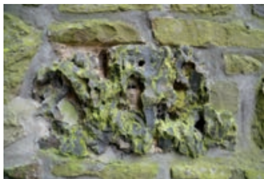
Abb. 33a, 33b: „Würmeriges Gestein“, Nordwest-Bereich des Turmes
