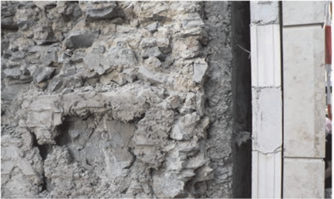
Abb. 28: Stückige Plänerkalksteine im Mauerwerk der Ostwand der Volksbankfiliale Schildern, Paderborn, März 2012.
