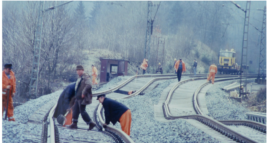
Abb. 5: Verschobene und verbogene Gleise nach Hangrutschungen am Paderborner Berg zwischen Neuenheerse und Willebadessen (Foto: Heinrich Glitz, 1988).
