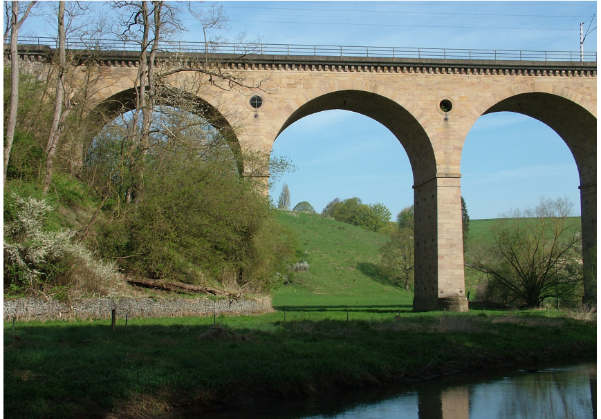
Abb. 6: Der Diemel-Viadukt bei Haueda – errichtet aus Sandsteinen des Mittleren Buntsandsteins (Foto: April 2018).
