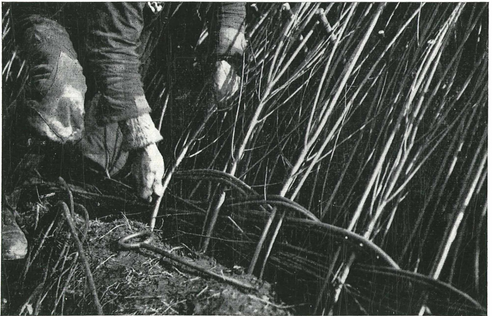
Bau einer Böschungssicherung an der Enns aus Weiden-Spreitlagen. Jede einzelne Rute muß geordnet werden, damit sie Wurzel schlagen und austreiben kann
