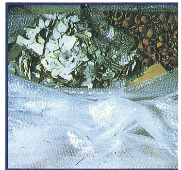
Abb. 22: Mäusenest auf ei-nem Dachboden aufgedeckt. Papier und Plastikfolie ge-ben eine gute Isolierung ab, die eingelagerten Nüsse lie-gen gleich daneben.
