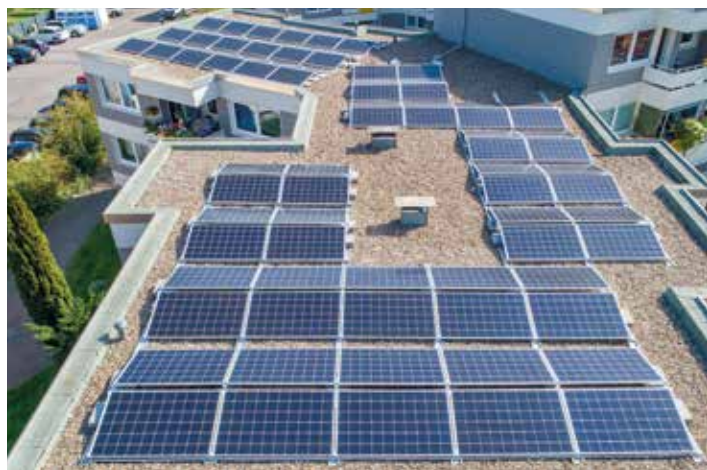
Mit Photovoltaik-Anlagen auf Gebäuden und Fassaden können Landschaftseingriffe vermieden werden: Das Potenzial dafür ist immens. In der Schweiz schätzt es der Bund auf 67 TWh Jahresproduktion, mehr als der jährliche Stromverbrauch beträgt (< 60 TWh). FOTO: PIXABAY/SOLARIMO
